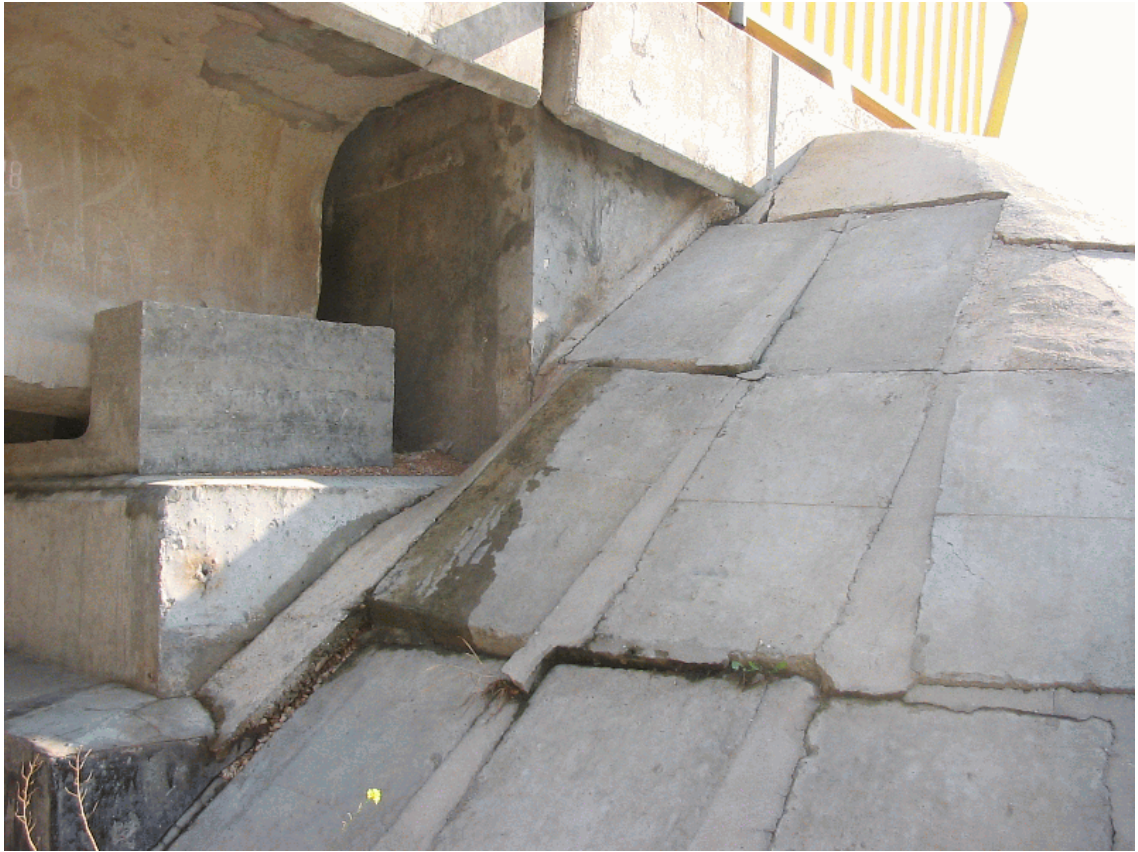
Фото 7 – Руйнування укріплення конусів берегової опори, сліди води на ригелі опори .
