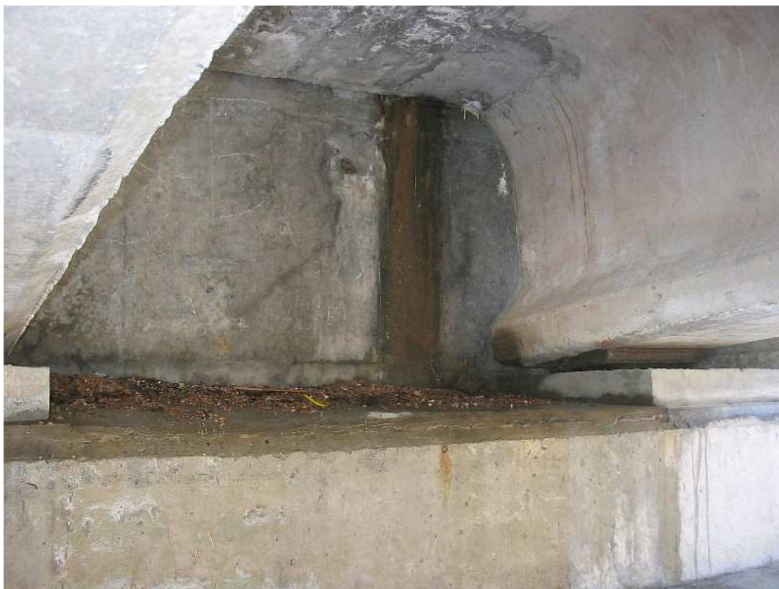
Фото 2 – Сліди води на ригелі опори.
