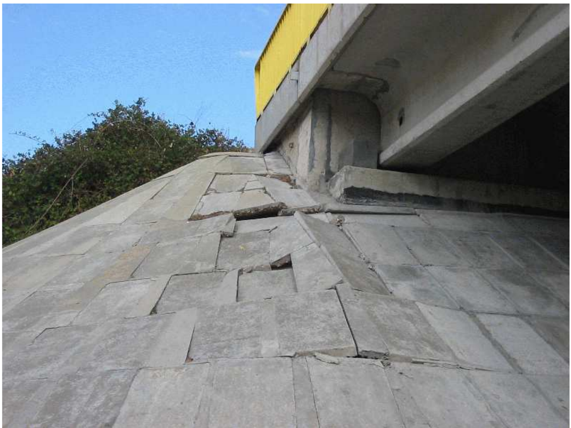
Фото 6 – Руйнування укріплення конусів берегової опори .
