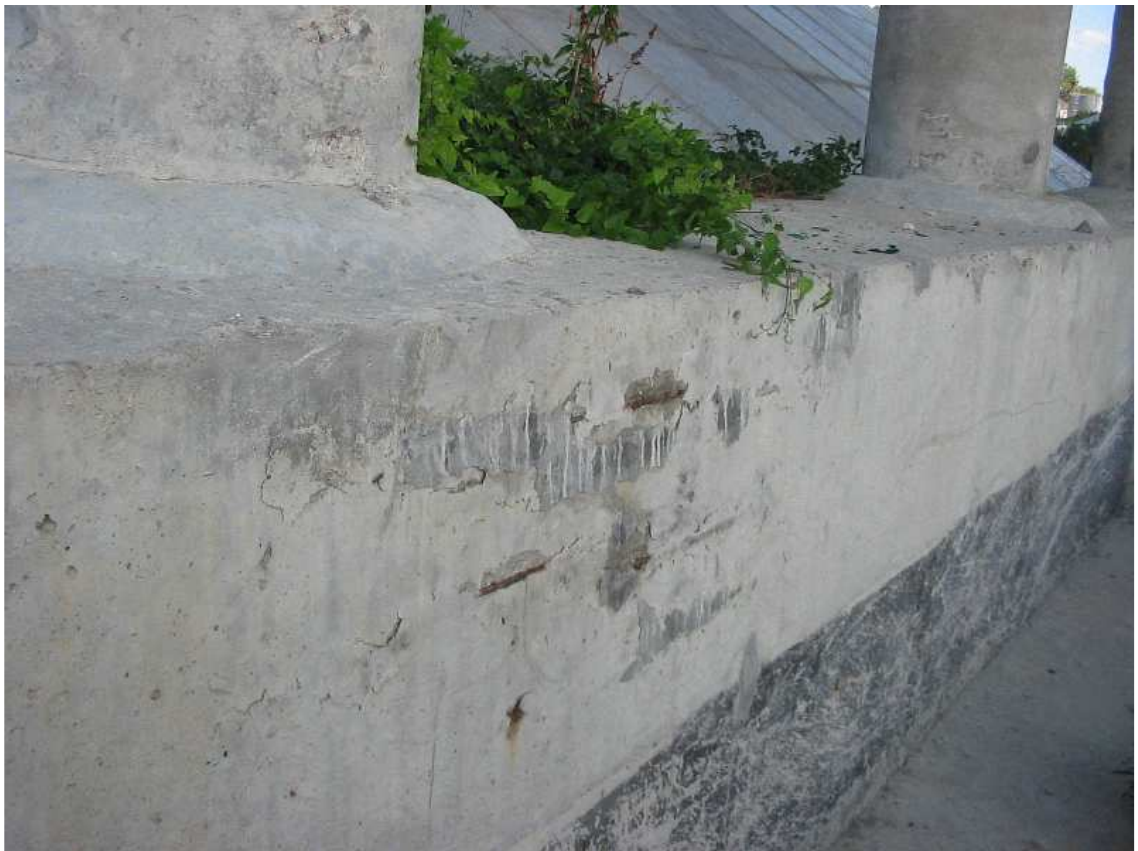
Фото 4 – Відколи бетону з оголенням арматури на опорі.
