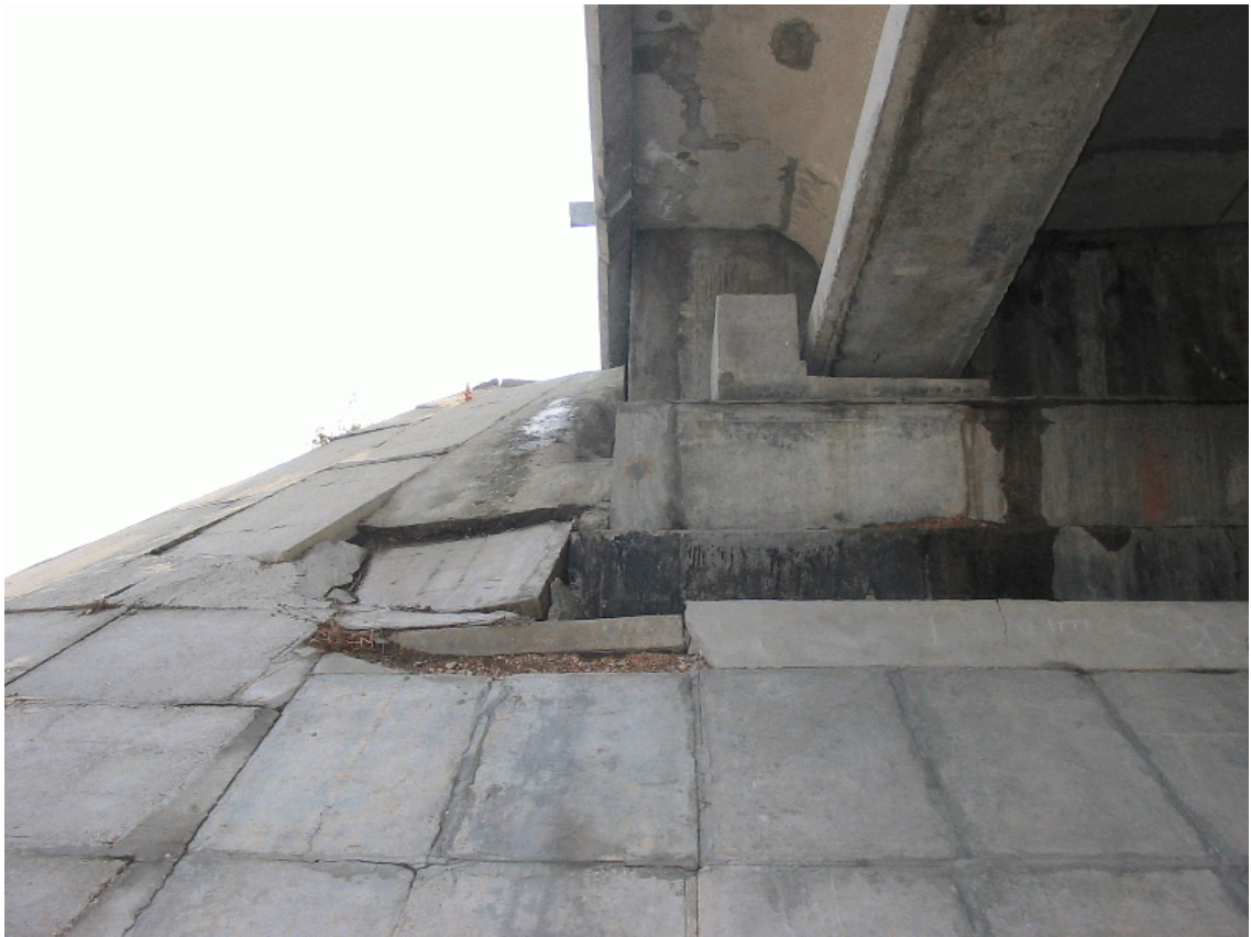
Фото 5 – Руйнування укріплення конусів берегової опори.
