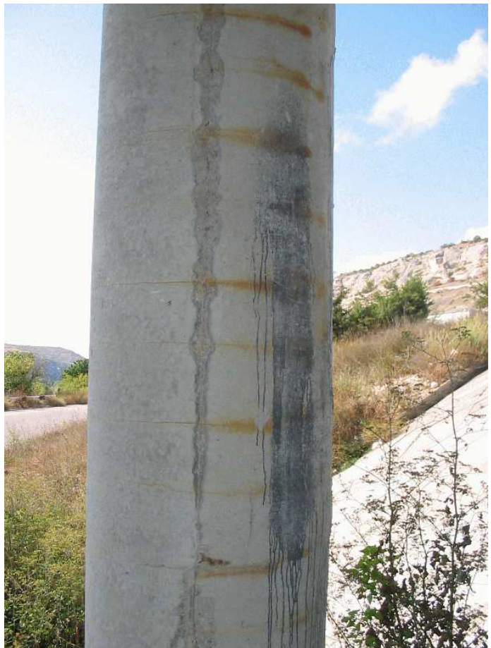
Фото 8 – Проступає іржа від арматури на поверхні бетона опори.
