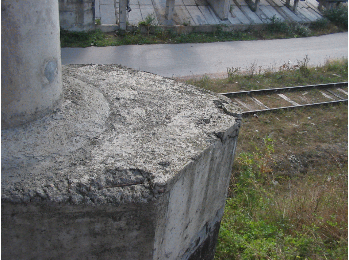
Фото 3 – Відколи бетону з оголенням арматури на опорі.
