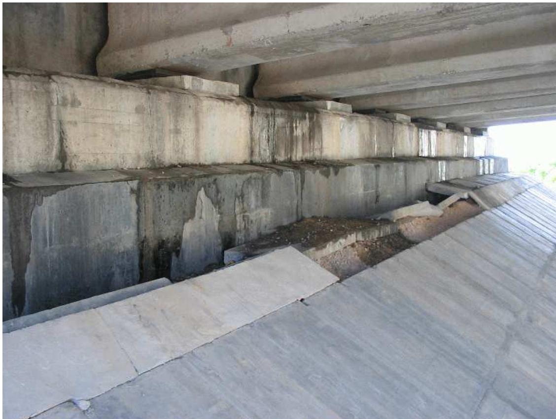
Фото 1 – Руйнування укріплення конусів берегової опори, сліди води на ригелі опори.
